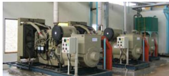
Gambar 3.10. Generator Diesel pada Pabrik Kelapa Sawit
