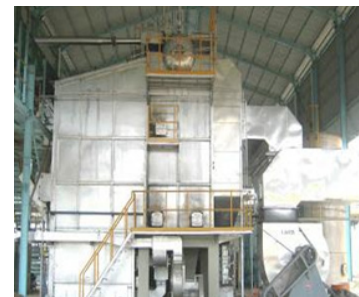
Gambar 3.8. Boiler pada Pabrik Kelapa Sawit
