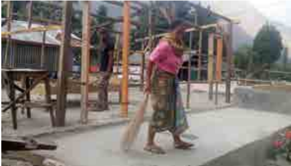
Inaq Ogi membersihkan sendiri lahan tempat rumahnya yang rusak berat dan ambruk, Lendang Luar (Sembalun Bumbung)
